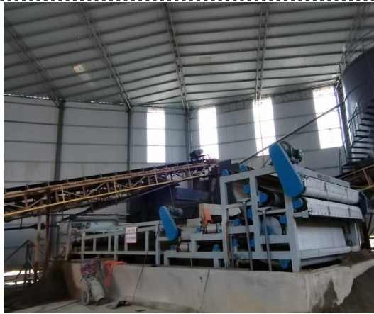
洗砂废水压滤脱泥机
