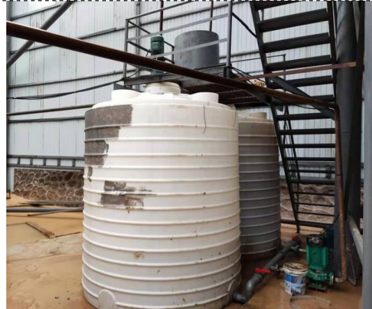
废水处理系统絮凝剂拌料罐
