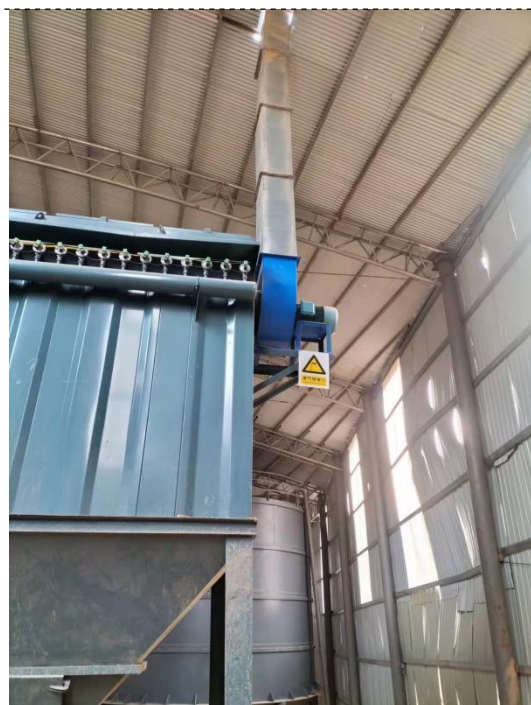
废气排放口标识
