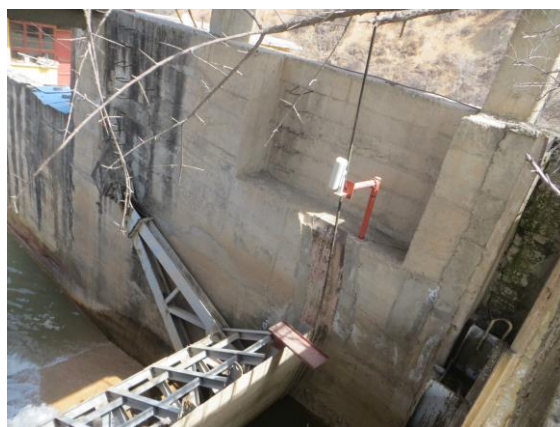
下泄流量监控装置
