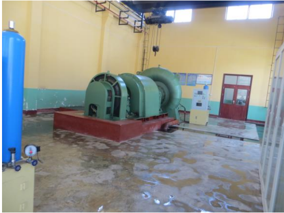
水电站发电厂房内景
